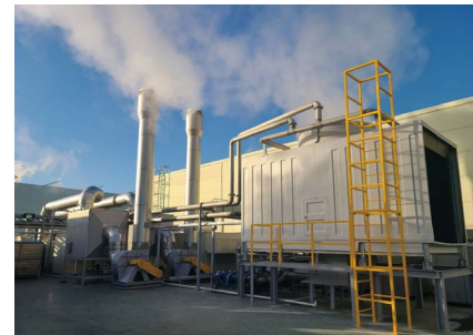
오뚜기라면 유증기 분리장치 설치 현황
