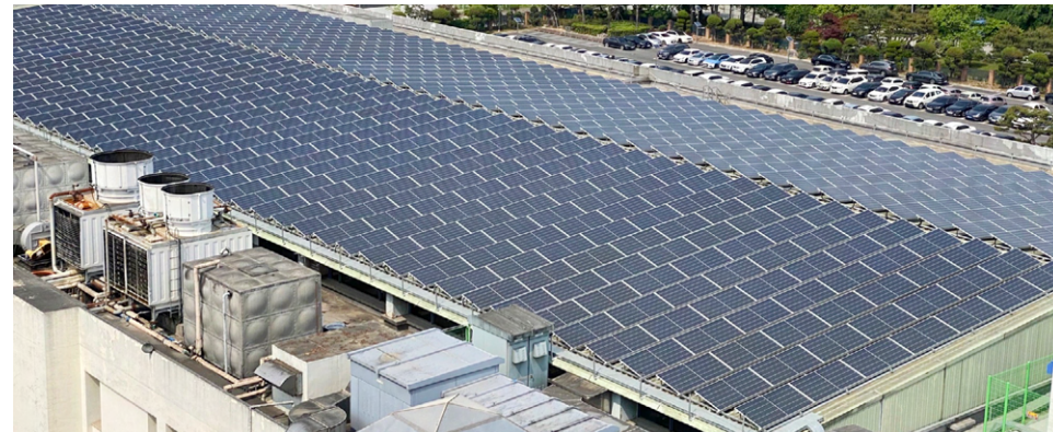
대풍공장 태양광 발전시설 설치(2022년 11월 완공)
