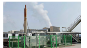
재증발 증기 폐열 회수 장치 설치
